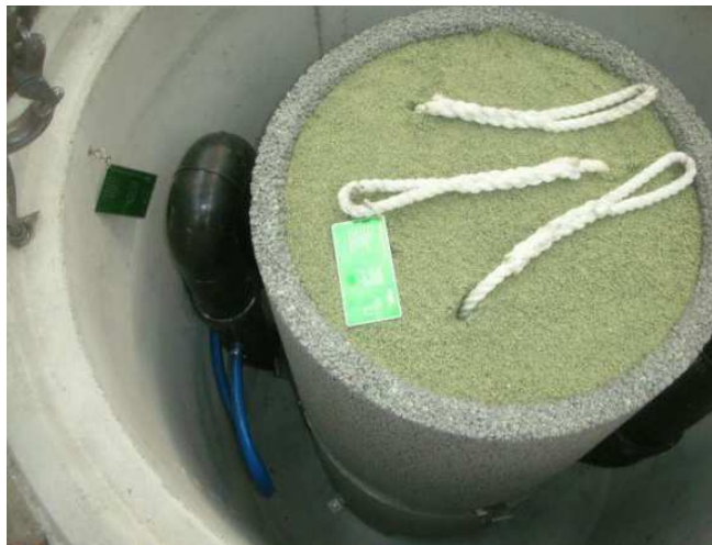
Particolare interno impianto
